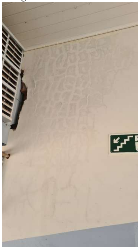
Figura 13 – Parede da cozinha
