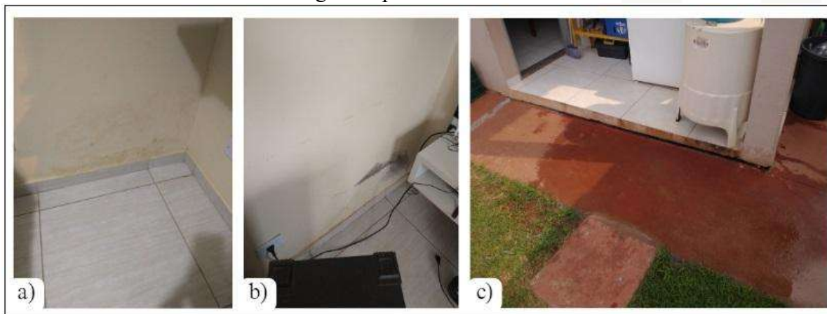
Figura 24 - Manifestações patológicas Residencial Recanto Verde fase III: a) Infiltração na parede vindo do banheiro (1); b) Infiltração na parede vindo do banheiro (2); c) Rachadura entre baldrame e o chão originado pelo afundamento do aterro
